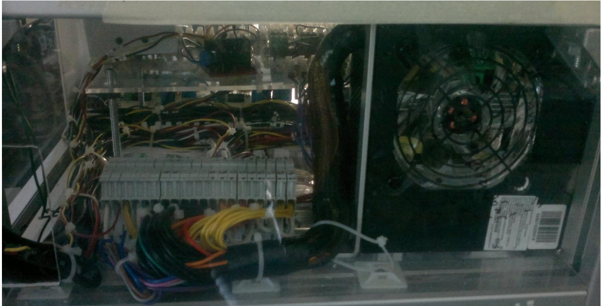
Figura 1.33: Vista lateral derecha del tablero de control.
