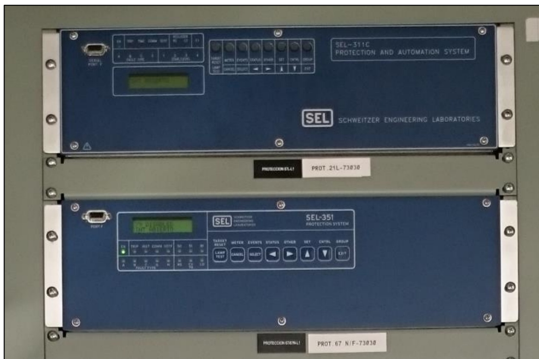
Figura 3.4 Relevadores de protección primaria y de respaldo en el extremo de la S.E. PQI de la línea PQI-73030-JIL-STU.
