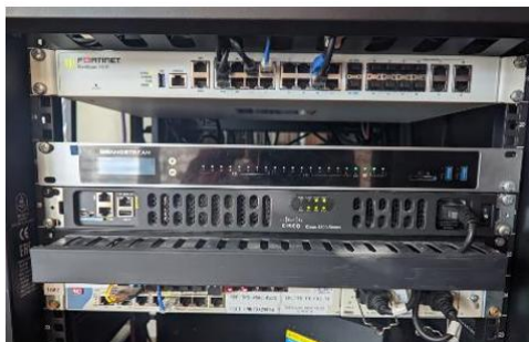
a) Conmutador instalado en el SITE
