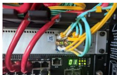
d) Activación exitosa en cada switch
