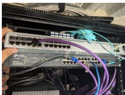
a) Instalación y organización en IDF
