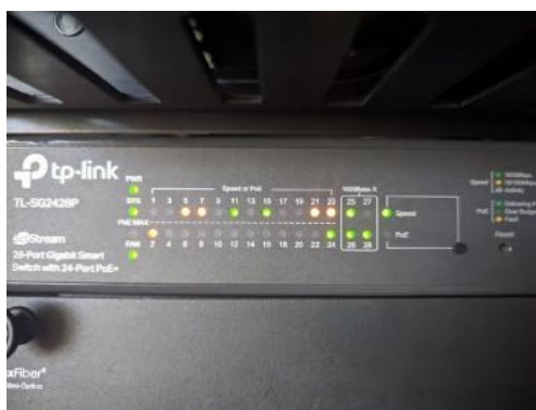
c) Indicadores de señal exitosa en switch principal SITE
