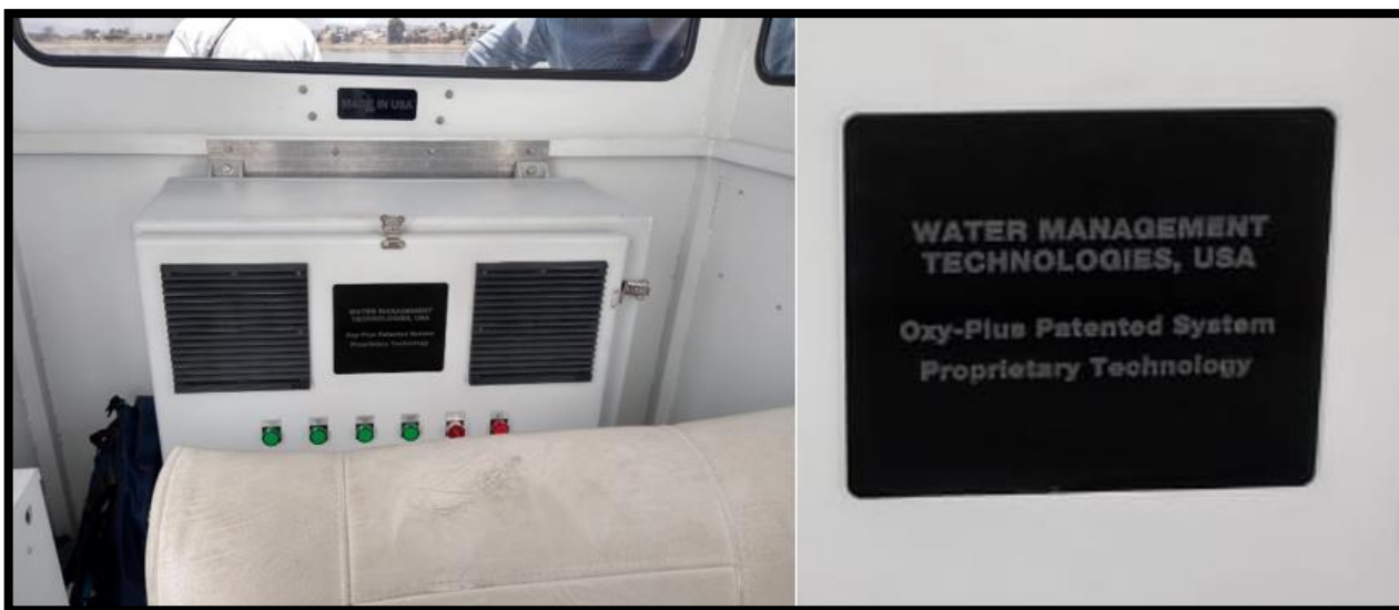
Ilustración AII 1. Tablero indicador del equipo de hiperoxidación de un Scavenger 2000™ cuando está en operación en el Humedal de Valsequillo. Fuente: propia (2019).
