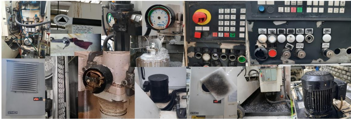
Nota Condiciones actuales de línea A de maquinado, donde se muestran equipos deteriorados, rotos o averiados. (2022)
