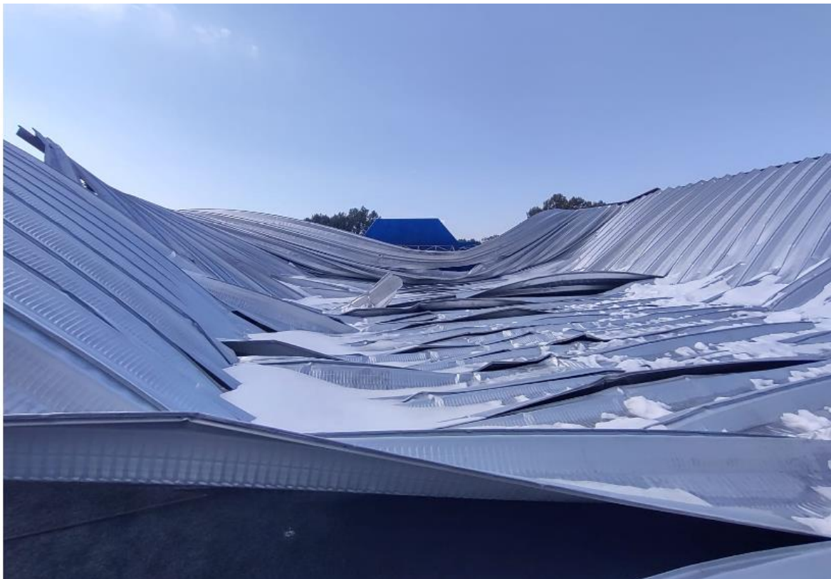
Fig. III.30 Colapso de cubierta curva en Tetla, Tlaxcala (autoría propia, 2021)
