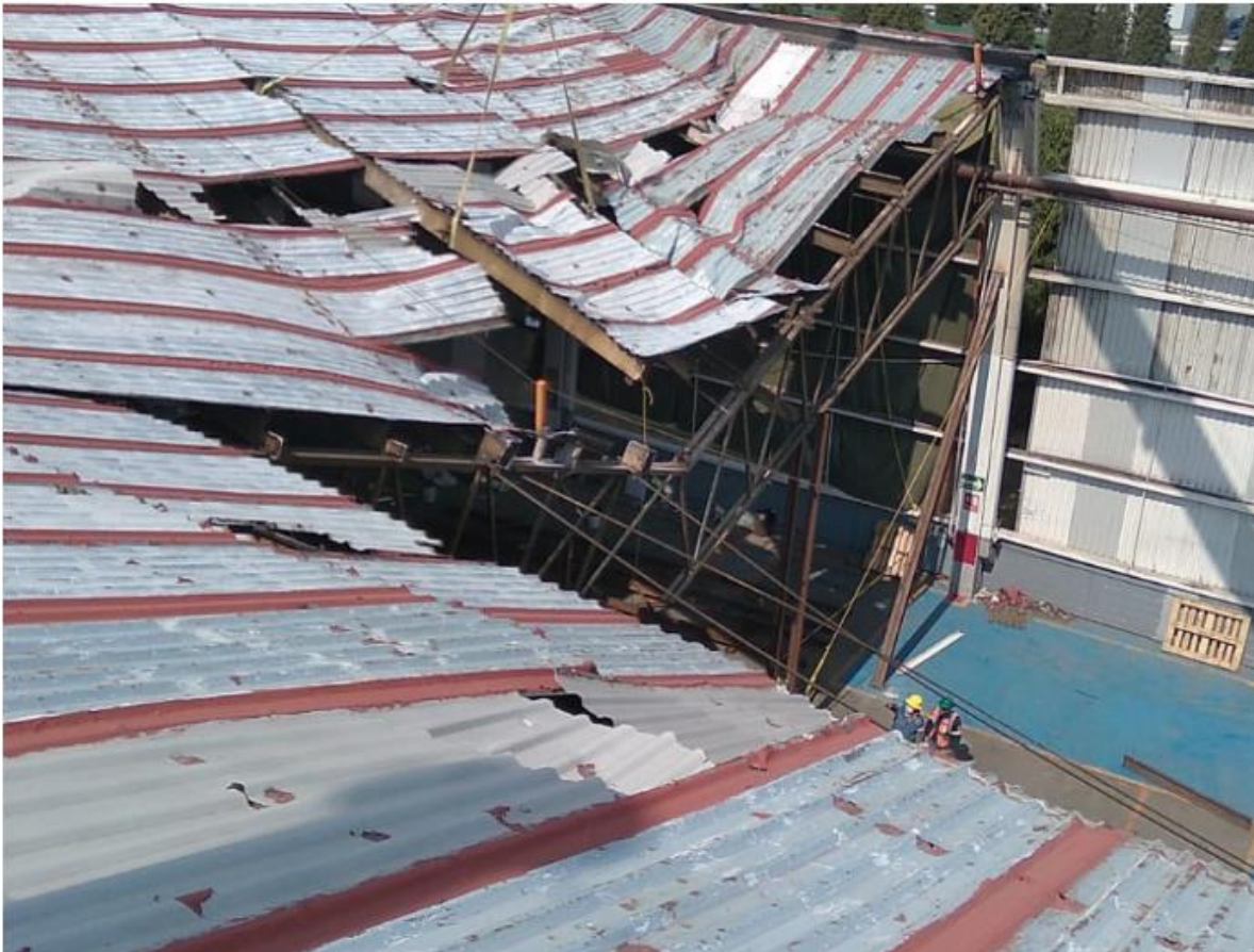
Fig. 1.4 Vista de la armadura colapsada. Se observa la flexión del elemento al centro del claro (Ing. Marco Antonio Sorcia, abril 2021)
