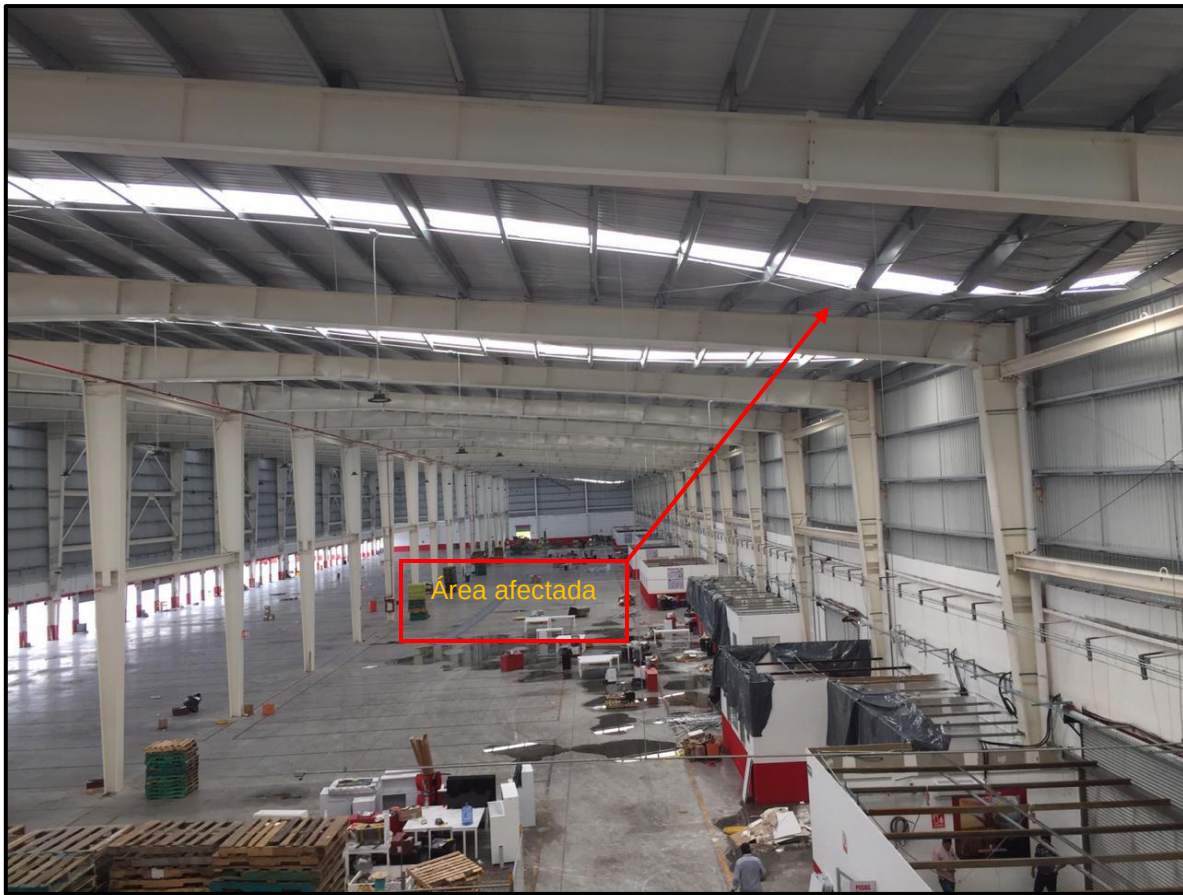
Fig. 1.2 Vista panorámica de la nave, se aprecian los daños en el techo y dentro de la nave por el agua que se introdujo (autoría propia, 2019)
