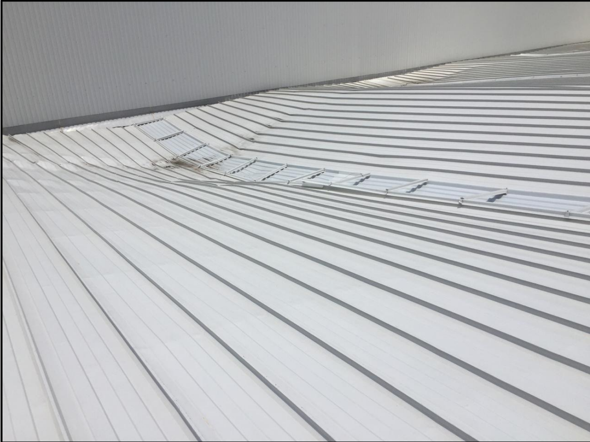
Fig. I.1 Vista del techo afectado, se aprecia el dobléz de la lámina en varios puntos por la acumulación del granizo (autoría propia, 2019)
