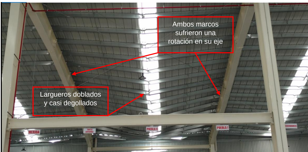
Fig. 1.3 Vista local de la parte inferior del techo afectado, se aprecia claramente el daño en los largueros (autoría propia, 2019)
