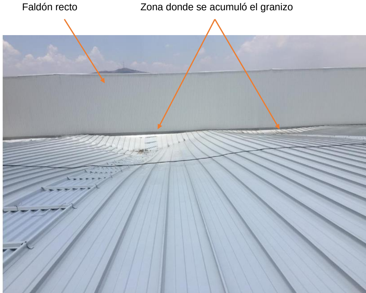
Fig. III.25 Acumulación de granizo por obstrucción de faldón recto en cubierta (autoría propia, 2021)
