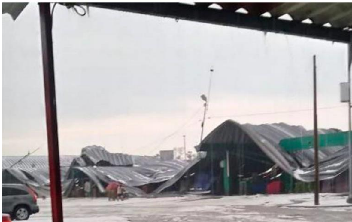
Fig. III.29 Cubierta colapsada en la central de abastos de la CDMX (El Informador, 2021)
