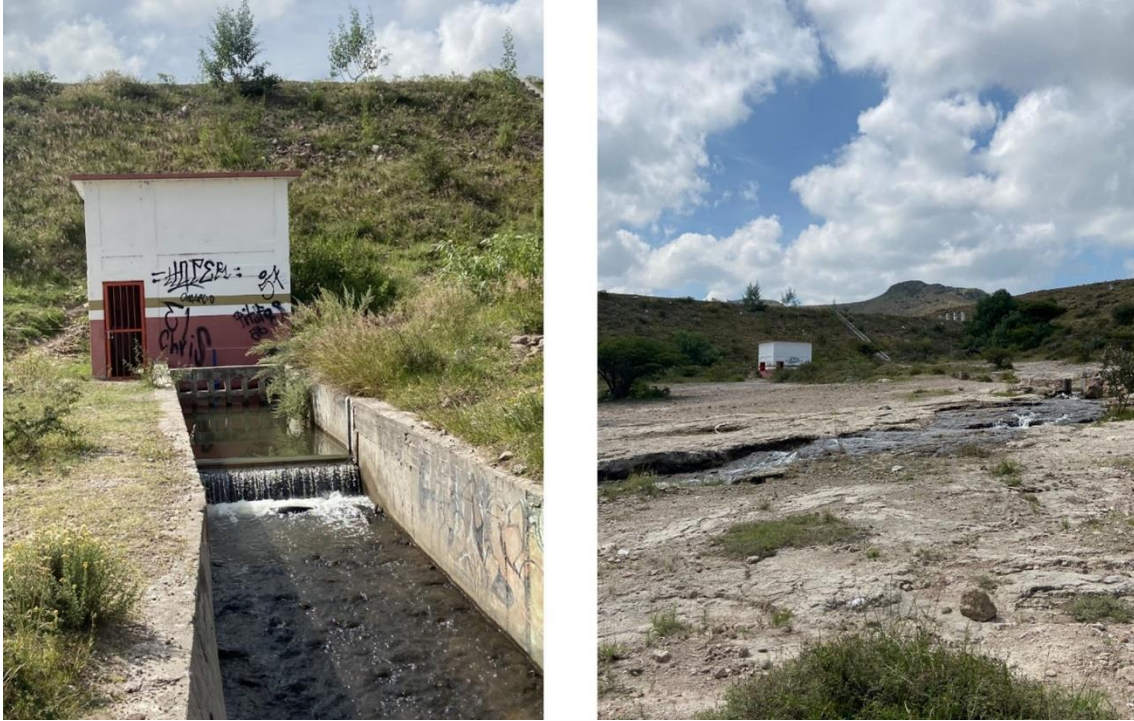
Figura 37. a) Caseta de obra de toma con canal de excedencia. b) Formación de riachuelo paralelo al perfil.
