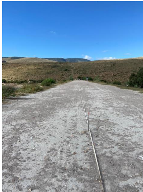
Figura 21. Tendido electródico de la TER manual sobre la corona de la presa Cañada del Lobo.
