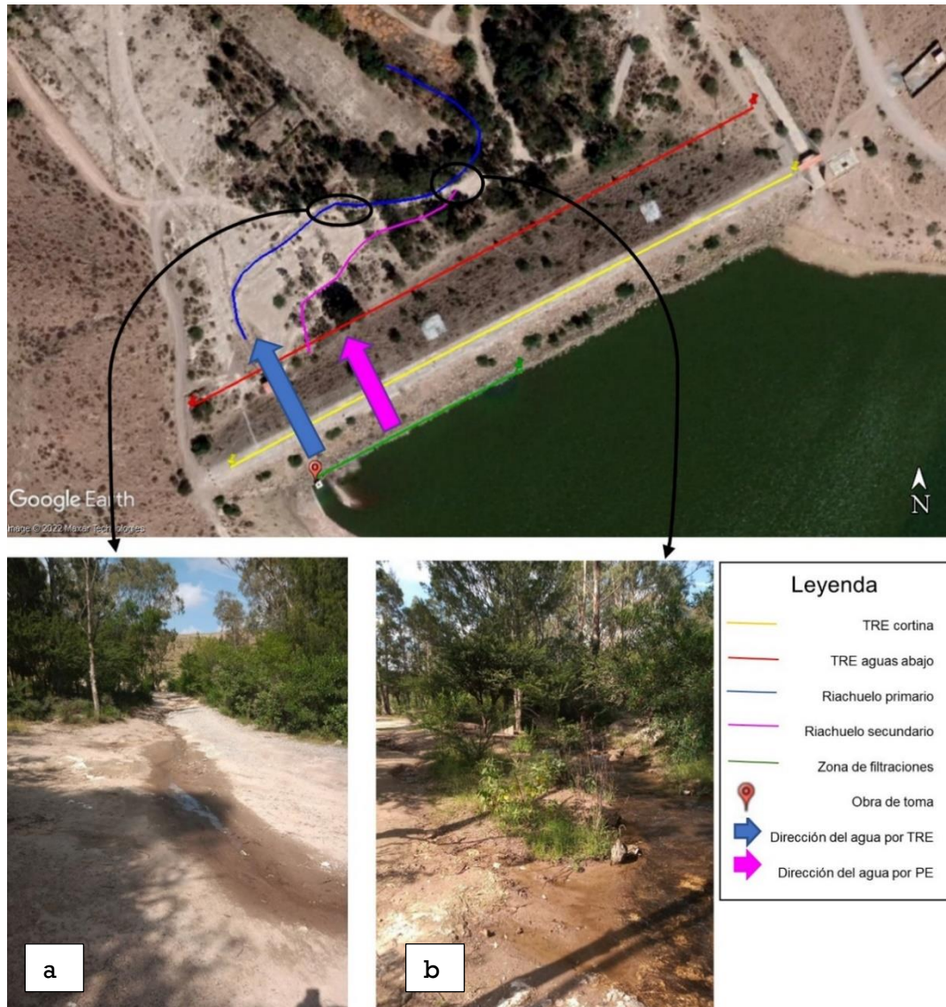
Figura 41. Mapa evidenciando la formación de dos riachuelos gracias a filtraciones en la cortina. a) Esgurrimiento de agua. b) Intersección del esgurrimiento y riachuelo secundario aguas abajo.
