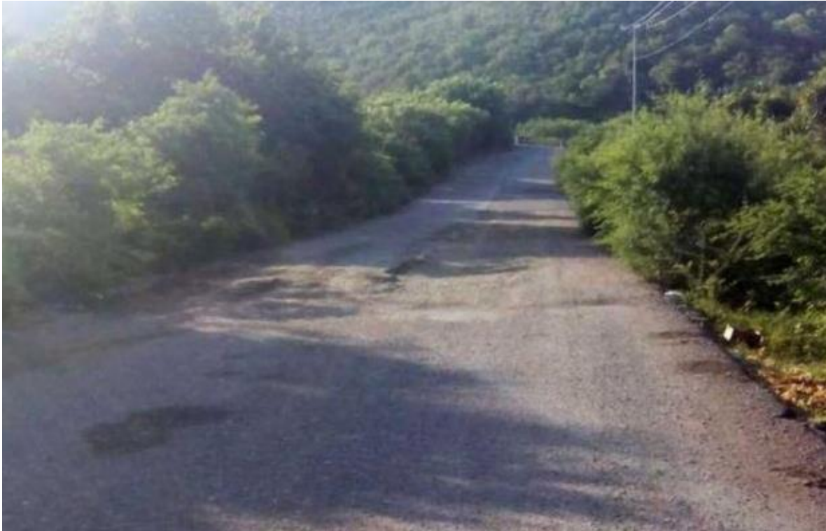
Fig. 2 Ruta de evacuación con baches
