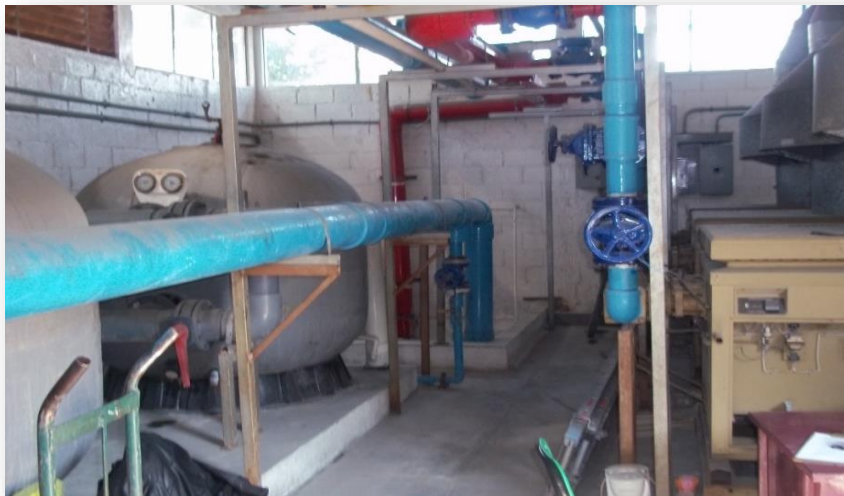
Imagen no. 42 vista actual del Cuarto de Máquinas del CENHCH tomada por Jesús Hernández Carrasco en enero del 2014, para la presente investigación
