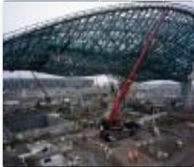
IMAGEN NO. 19 IMAGEN DEL PROCESO CONSTRUCTIVO TOMADA DE LA PAGINA WEB DEL ACUATIC CENTRE LONDRES
