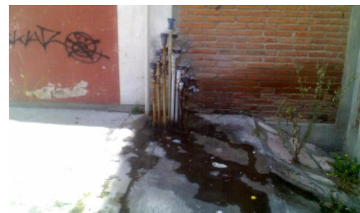
Fugas de agua Fuente: M.H.V.
