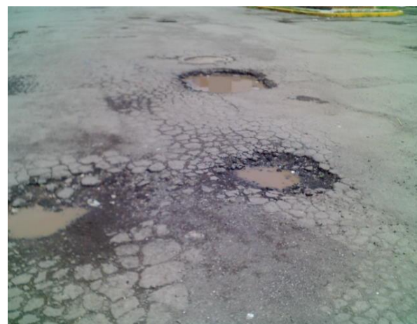
Vialidades en mal estado Fuente: M.H.V.
