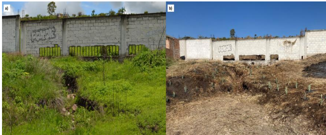
Figura 57. Comparativa de las condiciones (a) antes y (b) después de revegetar los márgenes de este escurrimiento. Fuente: Acosta, 2020-2022.
