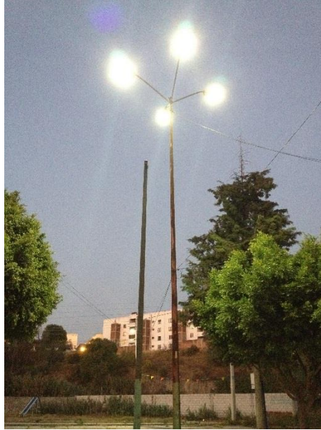
Ilustración 13. Luminarias. Salgado Montes, 2015.
