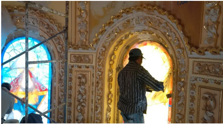
Imagen 164: Colocación de Argamasas en detalles decorativos del interior de la cúpula central del templo.
