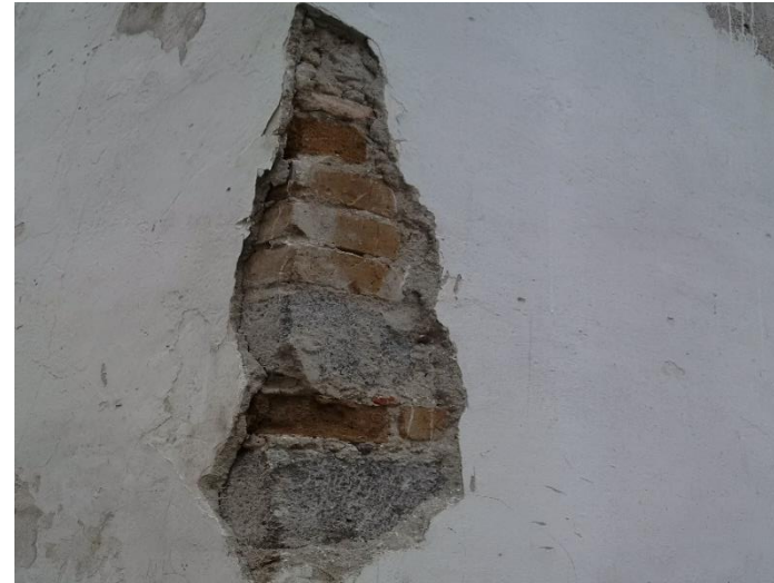
Imagen 139: Detalle del liberación de aplanado que ya no se encuentra consolidado en el muro de mampostería.
