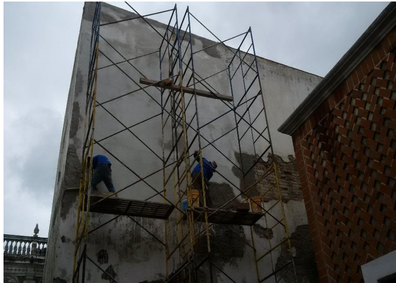
Imagen 143: Detalle de trabajo de integración de repellados en distintas zonas del muro de mamposteo.
