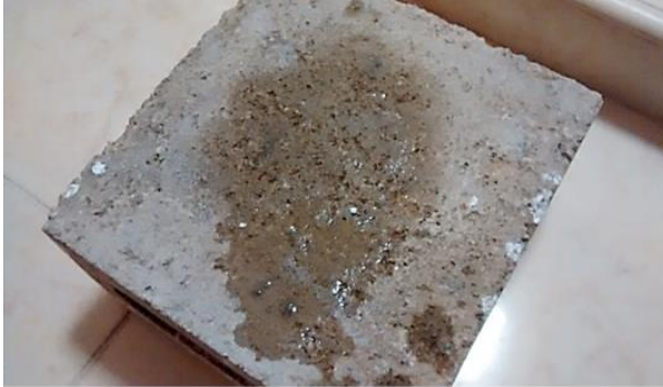
IMAGEN 34: ÁREA SIN IMPERMEABILIZANTE ABSORBE LA HUMEDAD.
