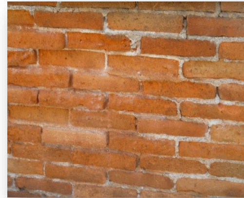
Imagen 102: Detalle de la disgregación de tabique por exposición a la intemperie.
