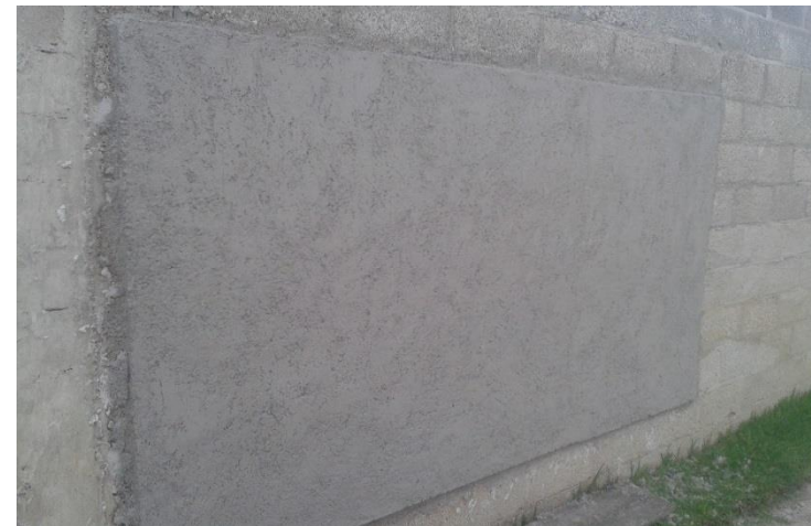
IMAGEN 32: COLOCACIÓN DE MORTERO BASE CAL-ARENA PARA APLANADO GRUESO COMO PRUEBAS DE RENDIMIENTOS.
