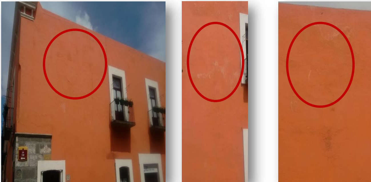
Vista del deterioro en aplanado. Inmueble ubicado en la calle 5 sur esquina 5 poniente Fuente: J. Jiménez Ortega
