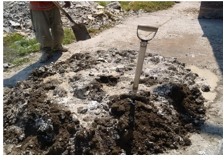
Imagen 161: Preparación de la cal apagada en obra y aplicación de la arena proporción 3:1.
