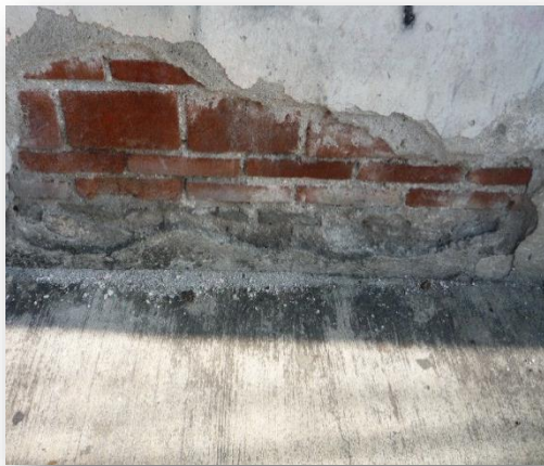
Imagen 101: Detalle de humedad de muro de tabique.
