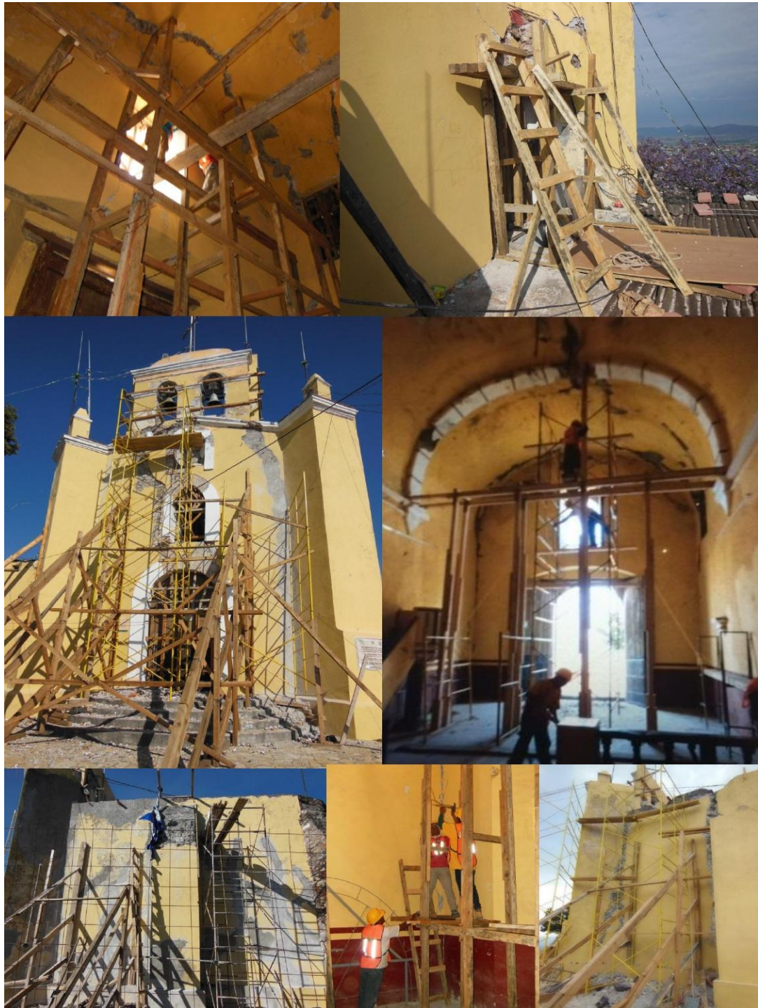
Imagen 118. Trabajos de apuntalamiento en la Capilla de San Miguel. Fuente: Graciela Walls. 9 de noviembre de 2017.
