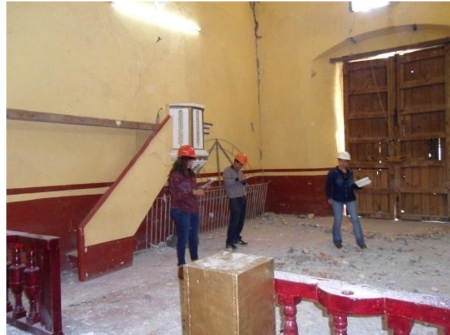
Imagen 159. Reconocimiento de los daños generados por el sismo del 19 de septiembre de 2017 en la Capilla de San Miguel. Fuente: CFLA. 7 de noviembre de 2017.
