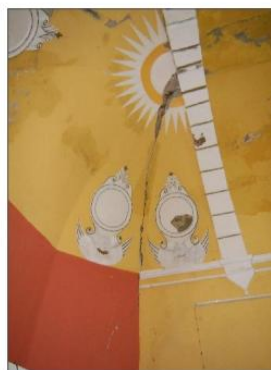
F2 GRIETA EN BÓVEDA DE PIEDRA ASENTADA CON MORTERO CAL-ARENA Y APLANADO CAL-ARENA.
