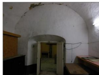
F2 FISURAS EN BÓVEDA DE CAÑÓN CORRIDO MAMPOSTERÍA MIXTA (PIEDRA-TABIQUE-TIERRA) ASENTADA CON MORTERO CAL-ARENA Y APLANADO CAL-ARENA.
