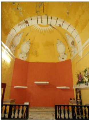
F1 GRIETAS EN MURO DE PIEDRA ASENTADO CON MORTERO CAL-ARENA Y APLANADO CAL ARENA.
