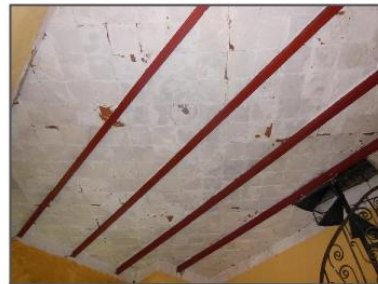
F2 GRIETAS EN CUBIERTA CATALANA PLANA SOBRE VIGAS DE ACERO CON TABIQUE ROJO COMÚN ASENTADO CON MORTERO CAL-ARENA.
