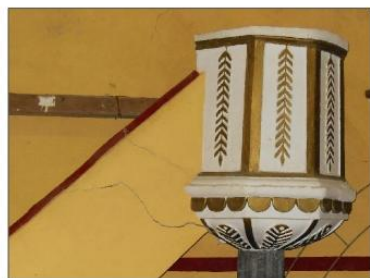
F1 GRIETA EN BARANDAL DE ESCALERA EN PÚLPITO DE TABIQUE ROJO COMÚN, ASENTADO CON MORTERO CAL-ARENA Y APLANADO CAL-ARENA.
