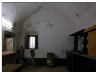
F1 DESPRENDIMIENTO DE APLANADO CAL-ARENA EN MURO MIXTO (PIEDRA-TABIQUE-TIERRA) ASENTADO CON MORTERO CAL-ARENA.
