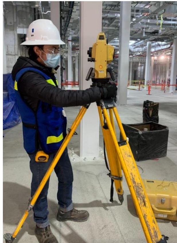
Imagen 4.8 Emplazamiento de equipo sobre eje “G” Jiménez J. 2022
