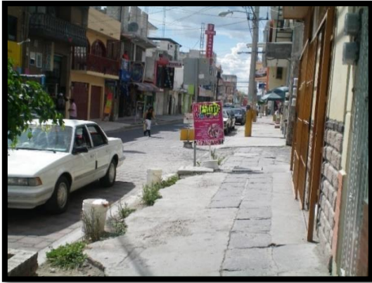
Foto 3.- Calle 5 pte. Área peatonal en mal estado. Arroyo vehicular en óptimas condiciones. Fuente: Fotos del Autor.
