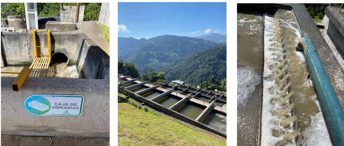
Figura 36. Proceso de operación de la PTAR
