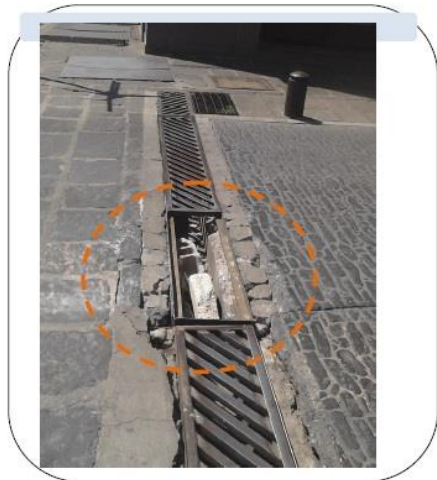
REJILLA PLUVIAL UBICACIÓN: 6 NORTE Y 6 ORIENTE
