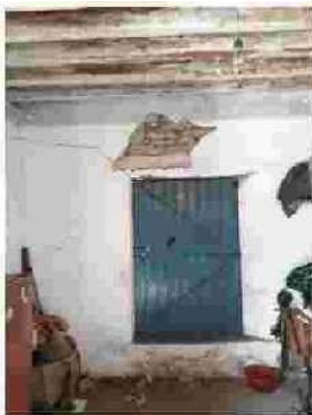
Imagen 57. Puerta del inmueble, daño por humedad en la parte superior y en la cubierta. Foto por Hernández, 2018.
