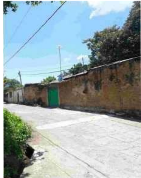
Imagen 23. El dintel de madera está fuertemente afectado, así como el recubrimiento del muro y el muro mismo. Foto por Hernández, 2018.
