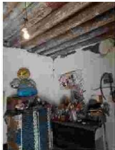
Imagen 58. Interior del inmueble, daño por humedad en la parte superior y en la cubierta. Foto por el Hernández, 2018.
