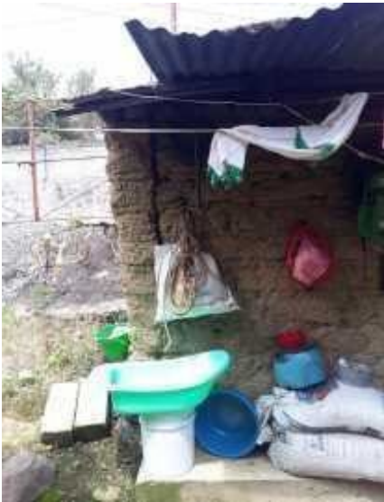
Imagen 38. Foto donde se aprecia separación de esquina. Foto por el autor
