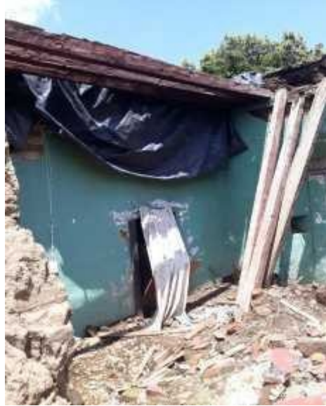
Imágenes 28 y 29. Habitación con falla en cubierta. Desde distintas perspectivas. Fotos por Hernández, 2018.
