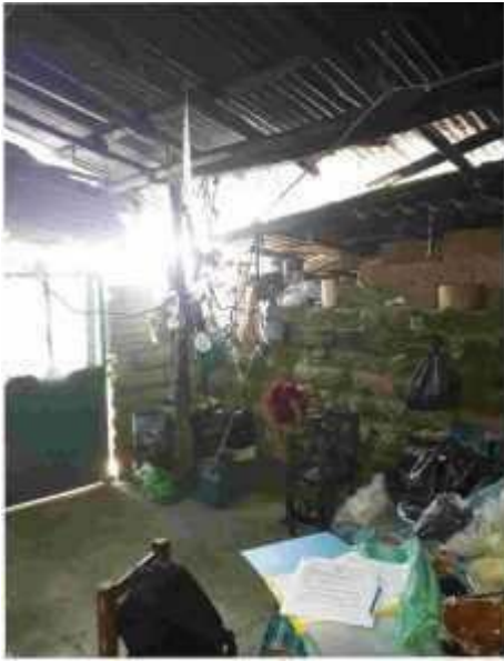
Imagen 24. Foto en perspectiva, viendo hacia la entrada de la vivienda. Se aprecian huecos entre el muro y la cubierta, así como un apoyo de madera. Foto por Hernández, 2018
