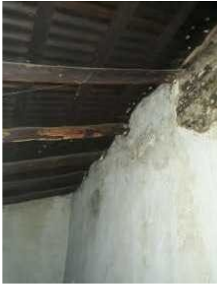
Imagen 20. Foto del muro en donde se aprecian problemas con humedad y vigas de madera pandeadas a razón de humedades. Foto por Hernández, 2018.
