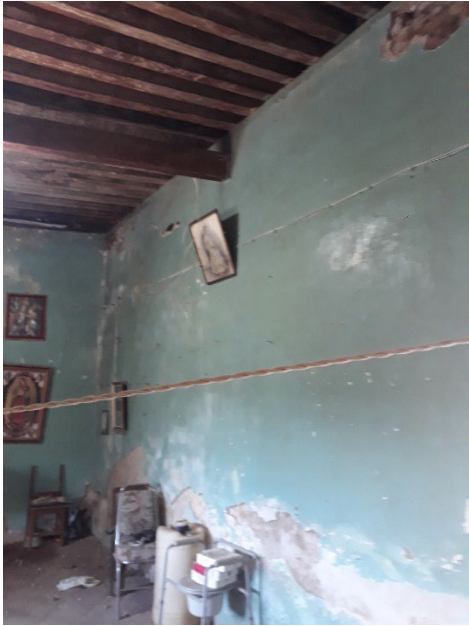
Imagen 30. Foto de detalle de muro. Donde se muestra afectación del mismo por humedad. Foto por Hernández, 2018.
