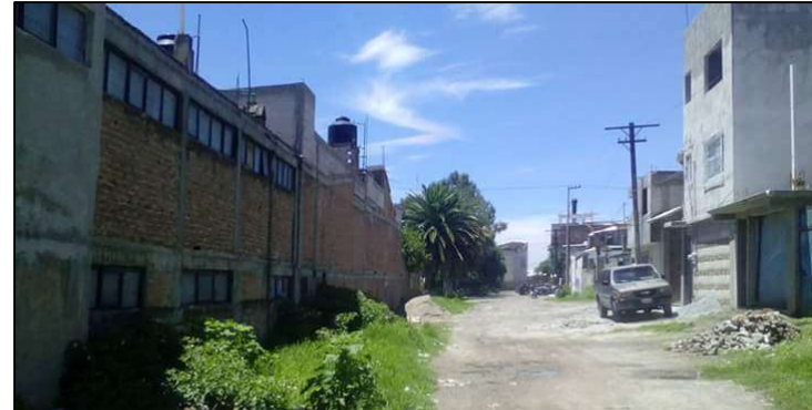
Ilustración 54 Fachadas con vegetación silvestre y humedades, sobre el tramo D.
