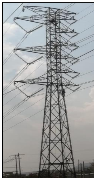
Figura 1. Torre Multi circuito. Dos conductores de hilo de guarda, modificada para pasar de 2 circuitos de 230 kV a 3 circuitos: 1 de 230 kV doble conductor del lado izquierdo, 2 circuitos de 85 kV lado derecho un conductor, contiene cadenas de aisladores en V.
