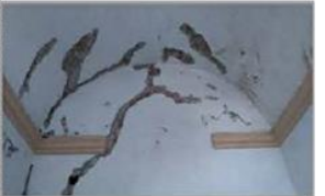
Presencia de grietas en muros Consolidación con piedra y mortero cal-arena. consolidación de aplanado con montero cal-arena.
