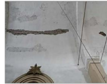
Presencia de humedad, presencia de microorganismos Erradicación de humedad y reintegración de aplastados cal-arena
