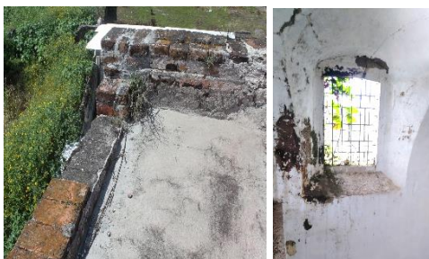
Foto 7. Vegetación parásita en bóveda. Foto 8. Grietas en bóveda. Foto 9. Perdida de material de fábrica en pretil. Foto 10. Vegetación parásita y mancha de humedad en ventana Autor: Guadalupe Vera, 2017-2018
