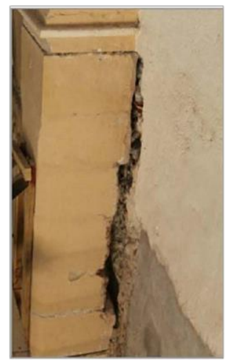
Presencia de grietas en pilastro y desplome de la misma. Consolidación con piedra y mortero cal-arena, plomado con soporte de viga L, consolidación de aplado con mortero cal-arena.
