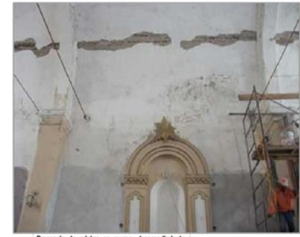
Presencia de grietas en muros, desprendimiento de materiales y aplados. Consolidación con piedra y ladrillo y mortero cal-arena, consolidación de aplado con mortero cal-arena.
