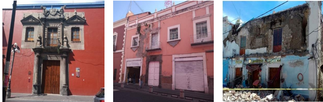
Diferentes condiciones de conservación del patrimonio edificado Foto 11. Casa del Dean, Puebla. Foto 12. Inmueble calle 5 sur 104, Puebla. Foto 13 Inmueble 3 norte esquina 6 poniente Atlixco. Fuente: Guadalupe Vera, 2019.
