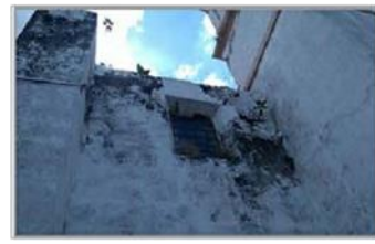
Presencia de humedad , presencia de microorganismos Erradicación de humedad y reintegración de aplandados cal-arena
