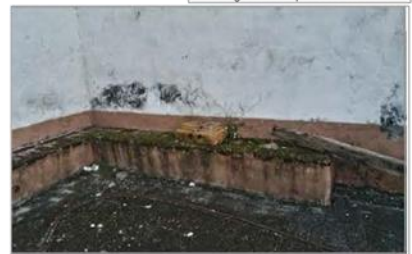
Presencia de humedad por capilaridad, presencia de microorganismos Erradicación de humedad en muros, reintegración de aplandados cal-arena
