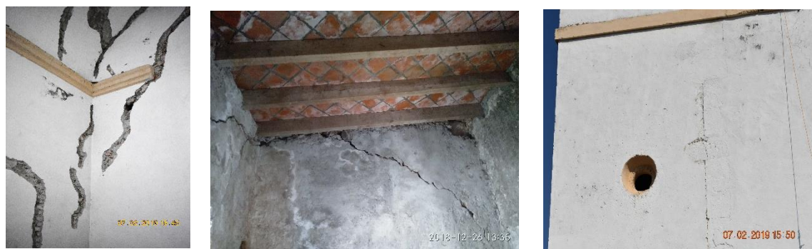
Foto 4. Grietas y fisuras en sacristía. Foto 5. Grietas en baptisterio. Foto 6. Grietas y fisuras en fachada Autor: Guadalupe Vera, 2017-2018
