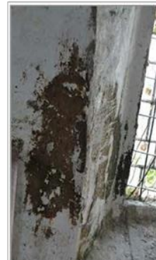
Presencia de humedad, presencia de microorganismos Erradicación de humedad y reintegración de aplastados cal-arena
