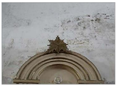
Presencia de humedad, presencia de microorganismos Erradicación de humedad y reintegración de aplados cal-arena
