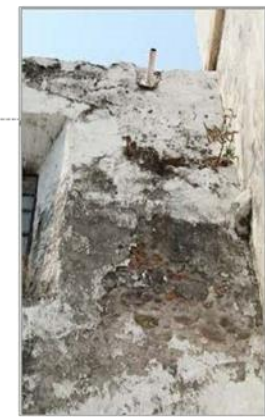
Presencia de grietas en muros Consolidación con tabique y mortero cal-arena. consolidación de aplandado con montero cal-arena.
