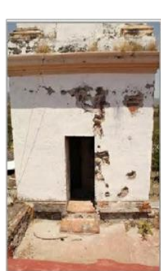
Presencia de grietas en muros, desprendimiento de materiales y consolidación con piedra y mortero cal:arena, consolidación de aplado con montero cal:arena.
