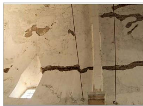
Presencia de humedad, presencia de microorganismos Erradicación de humedad y reintegración de aplados cal-arena Presencia de grietas en muros, desprendimiento de materiales y aplados. Consolidación con piedra y ladrillo y mortero cal-arena, consolidación de aplado con mortero cal-arena.
