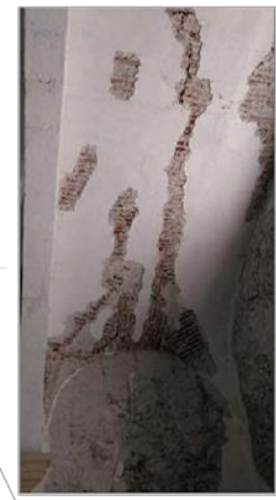
Presencia de grietas en muros, desprendimiento de materiales y aplados. Consolidación con piedra y ladrillo y mortero cal-arena, consolidación de aplado con mortero cal-arena.
