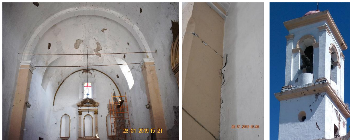
Foto 1. Grietas y fisuras en bóveda. Foto 2. Grietas y desfasamiento de pilastras. Foto 3. Grietas y fisuras en torre. Autor: Guadalupe Vera, 2017-2018
