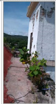
Presencia de plantas parásitas y microorganismos Erradicación de plantas parásitas y microorganismos
