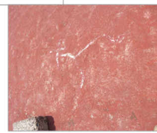
Presencia de grietas Inyección de grieta en cubierta con expansor y mortero cal-arena
