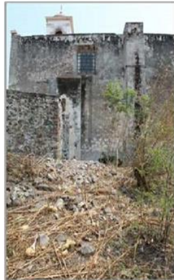
Presencia de humedad, presencia de microorganismos Erradicación de humedad y reintegración de aplados cal:arena
