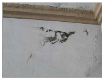
Presencia de humedad, presencia de microorganismos Erradicación de humedad y reintegración de aplanados cal-arena
