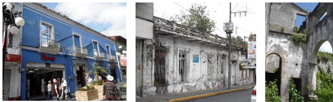
Diferentes alteraciones y deterioros en la vida útil de los bienes inmuebles Foto 14 y 15. Inmuebles históricos en Orizaba, Veracruz. Foto 16 Inmueble histórico en Xiutetelco, Puebla Fuente: Guadalupe Vera, 2019.
