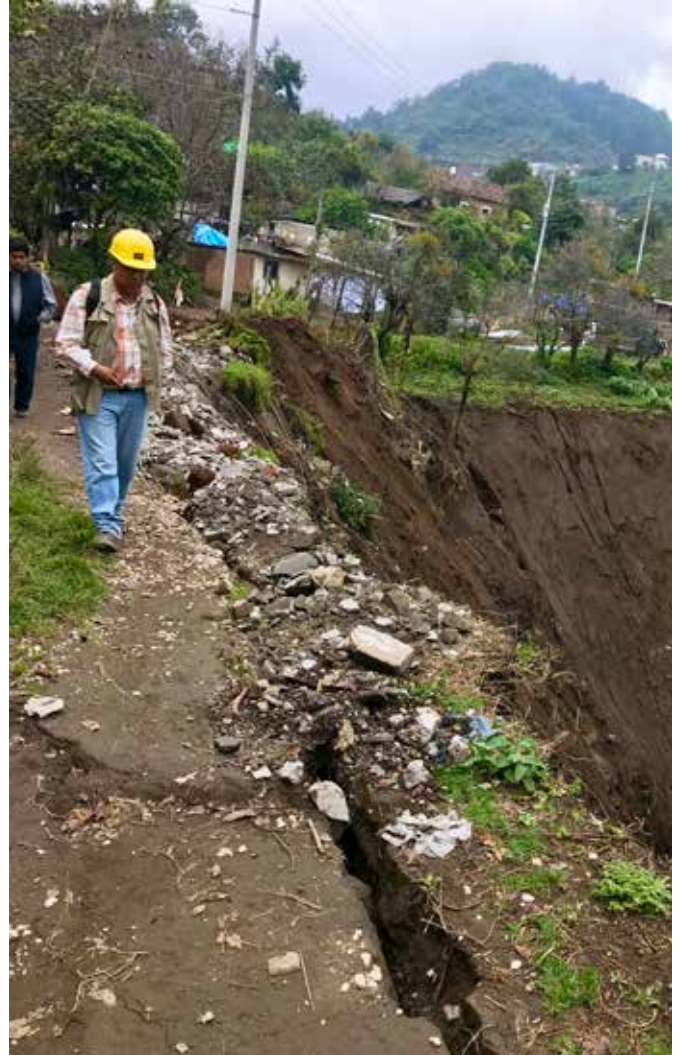
Desplazamientos de tierra en Santa Cruz Cuautumatitla (2017).
