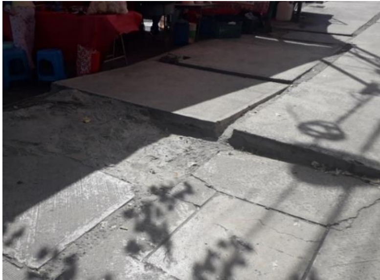
Fotografía 3 Acera rota av. 117 Pte.
