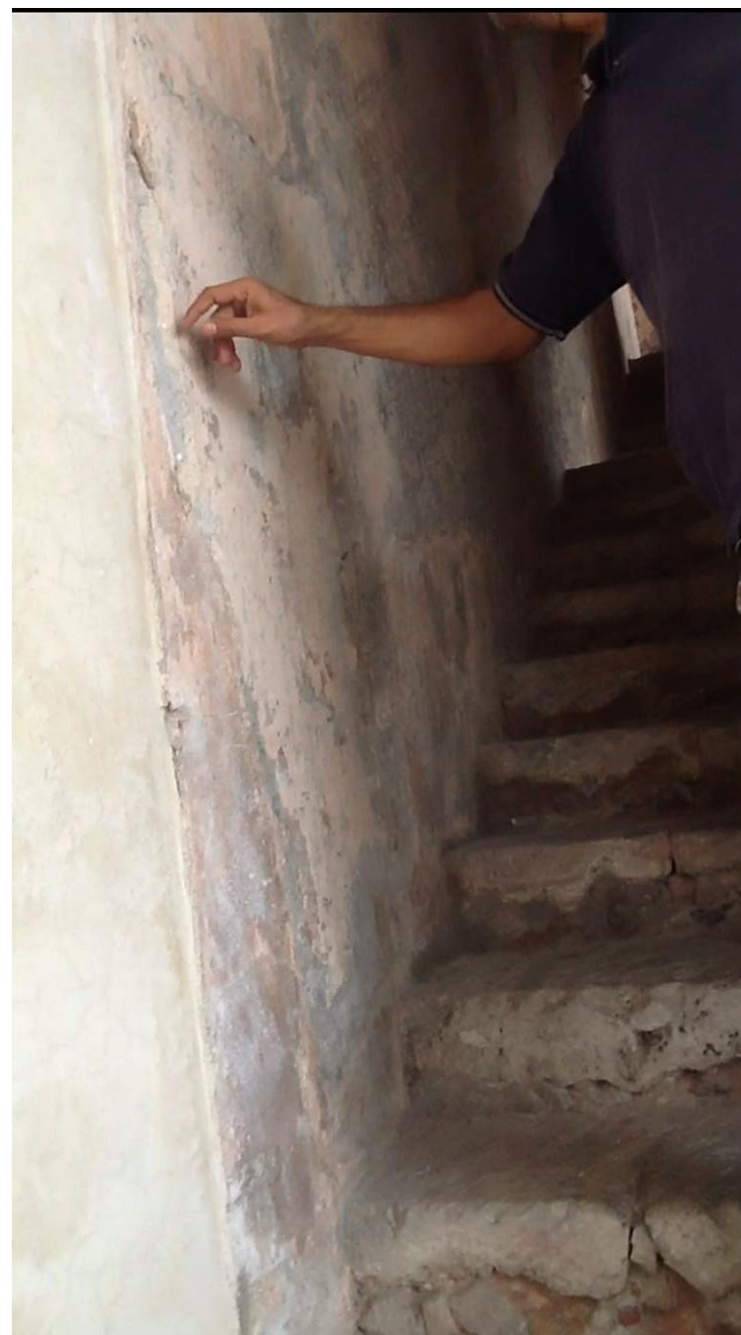
Fig.146.Desprendimientos de aplanados recién colocados, en el San Juan de Ulúa. Foto: Angelina del C. González Díaz.
