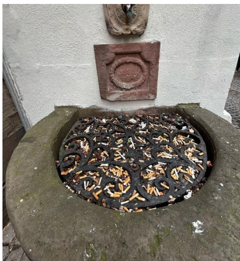
Figura 1.- Coladera ubicada cerca de CU (Elaboración propia) (13/04/2025)
