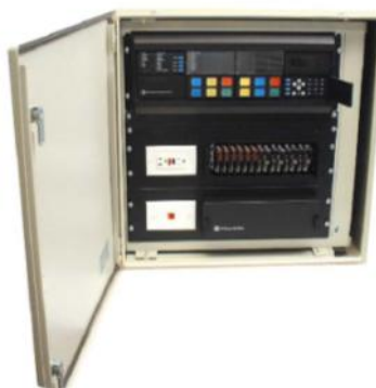
Fig. 2.1 b) Unidad de control "UCR" de General Electric.
