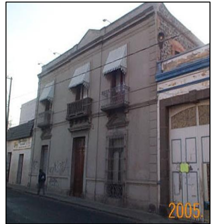
Edificio No. 2204, sobre la calle 5 Norte, s. XVII y XIX Fuente: M.A.G.F., Febrero 2005
