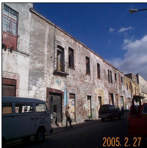
En el 2005, inmueble No. 2003. Se encontraba en estado ruinoso, pérdida total de cubiertas y sin uso.
