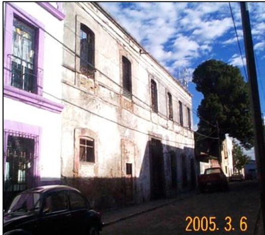
Inmueble No. 2005 sobre la calle Melchor Ocampo, se encontraba en mal estado, pérdida parcial de cubierta y sin uso. Fuente: M.A.G.F., Marzo 2005
