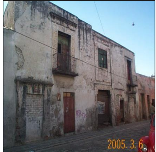
Arriba inmueble No.2006 sobre la calle Melchor Ocampo. Multifamiliar con pérdida parcial de cubierta y parcialmente habitado.
