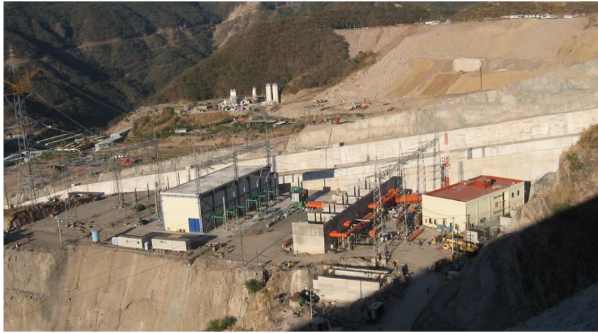
Figura 1.5 Subestación Eléctrica El Cajón, ubicada en Nayarit. (Fuente: http://mapio.net/o/1009060/ )
