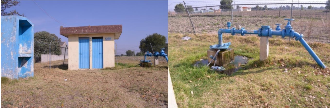
Pozo ubicado en Xahuen Vargas, caseta para las instalaciones eléctricas y estancia para el bombero (izquierda), tren de descarga con fugas (derecha).
