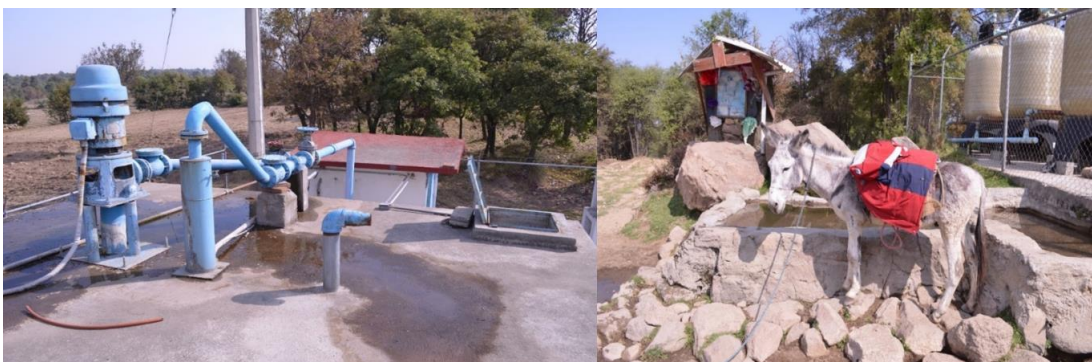
Depósito de bombeo (izquierda), desarenadores y bebedero para animales (derecha), los desarenadores se dejaron de usar porque el agua dejó de salir con arena.
