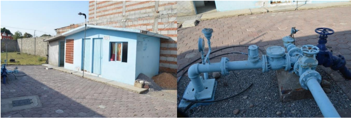
Oficina (izquierda) y tren de descarga que alimenta un depósito y un tanque elevado (derecha). Fotografía 4.9. Caseta del Pozo 2. Fotógrafo: IDRC. Fecha: 04-05-2016.
