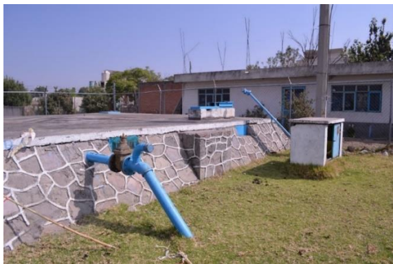
Fotografía 3.4. Depósito distribución de San Isidro Buen Suceso. Fotógrafo: IDRC. Fecha: 14-04-2016.
