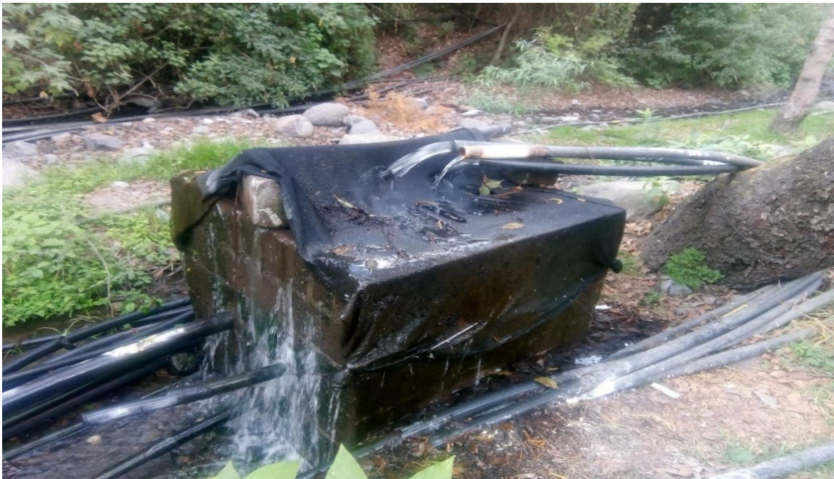
Foto 9. Caja de concreto con conexión de mangueras. Octubre, 2020. Foto: Diana Laura Yañez Reyes.
