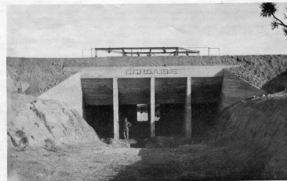
Alcantarilla controlada por la Compañía en 1910 debajo del Canal Principal en el Arroyo de Balam para impedir que las crecientes resquejen el Canal con la pérdida resultante a las cosechas.
