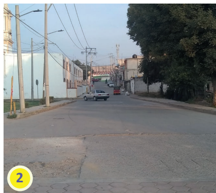
Vista 2. Calle 7 de Diciembre. Accesibilidad peatonal deficiente.
