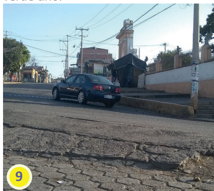
Vista 9. Cruce inseguro y nodo conflictivo. Calle 5 de Mayo.
