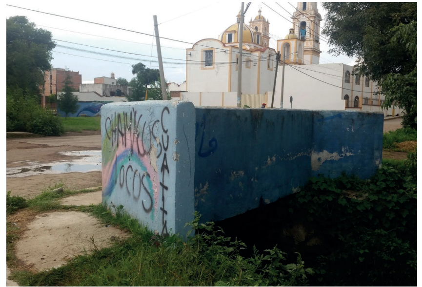
Imagen 36. Grafitis en el puente del río. Fuente: Visitas de campo 2019
