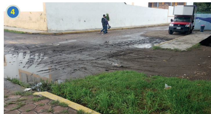
Vista 4. Encharcamiento calle Libertad.
