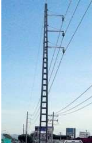
Figura 21 Poste Morelos Tipo I
