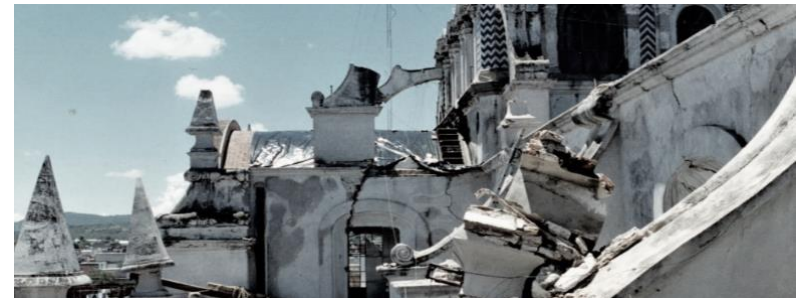
Ilustración 2. Daños ocasionados por el sismo de Tehuacán en 1999. Fuente: CUPREDER, BUAP.
