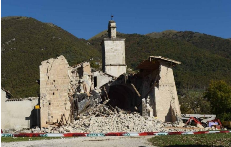
Ilustración 53. Danos ocasionados por el sismo de 2016 en la Iglesia de San Salvatore in Campi, Italia. Fuente: Periódico Avvenire
