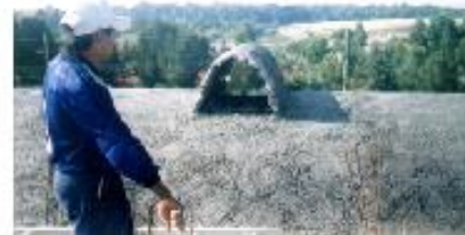
Etapas de colado de la bóveda díptera: armado y colado. Obra: casa-habitación, San Andrés Cholula, Pue. (1999). Construcción: Arq. Víctor Hernández Cabrera
