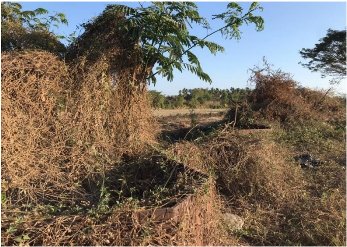
Fig. 14 Flores M., Vegetación seca sobre muro de tablaestaca
