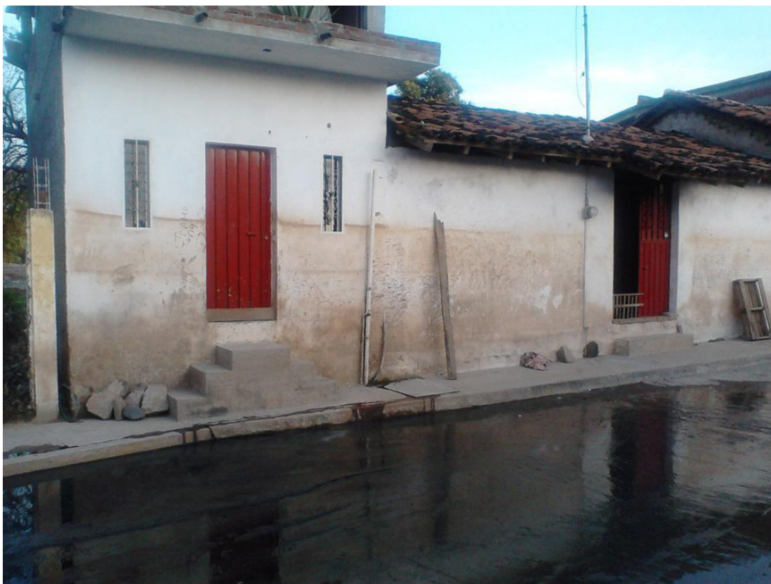
Fig. 10 Flores M., Límite de inundación en una casa afectada en la calle industria
