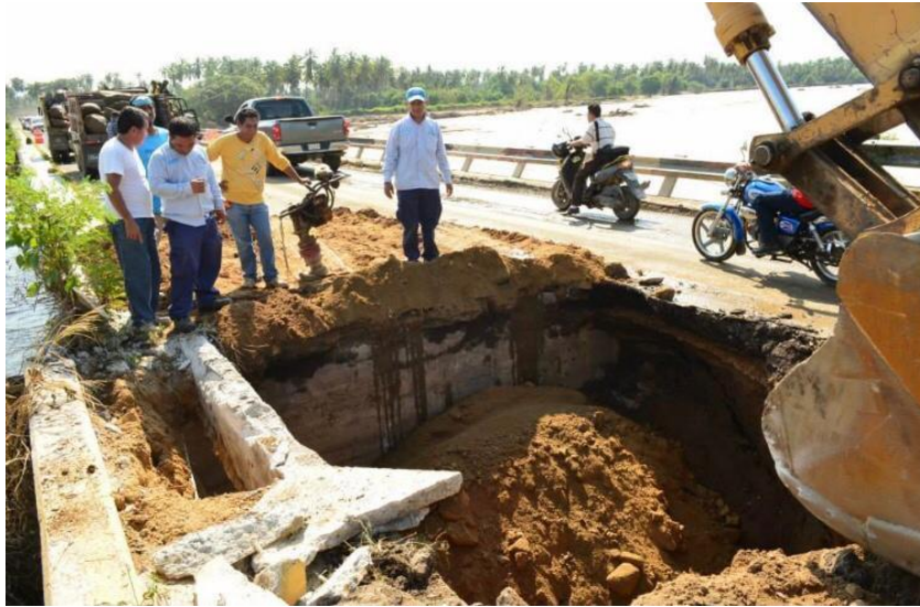
Fig. 9 Socavamiento en el puente de San Jerónimo durante la inundación en 2013. Recuperado de: Ven a San Jerónimo el Grande
