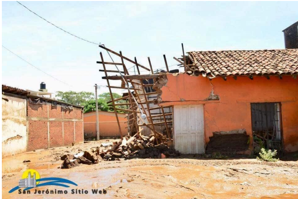
Fig. 8 Casa derrumbada tras el paso de “Ingrid” y “Manuel” en septiembre de 2013
