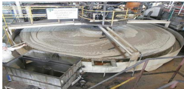
Figura 22. Clarificador Fuente: Archivo fotográfico ISRP, 2006
