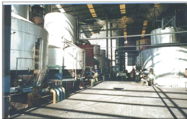
Figura 24. Evaporadores Fuente: Archivo fotográfico ISRP, 2011
