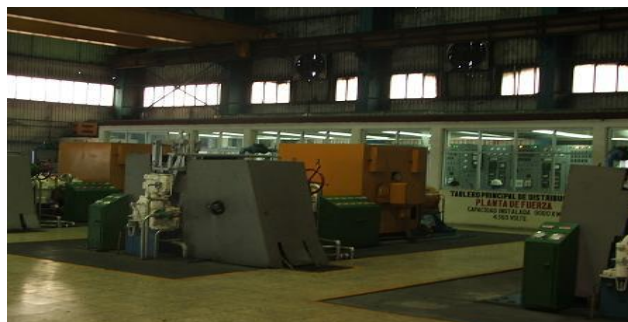
Figura 20. Turbogeneradores de energía eléctrica
