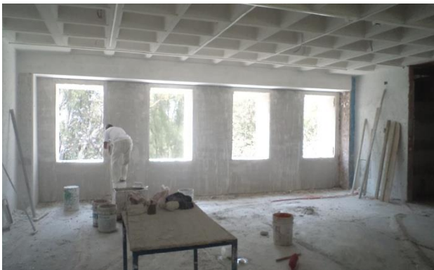
RESANES EN MUROS. 2° NIVEL. EDIFICIO 104-D DE LA FACULTAD DE CIENCIAS DE LA COMPUTACIÓN. FUENTE: ARCHIVO PERSONAL ( Anexo No.113 )
