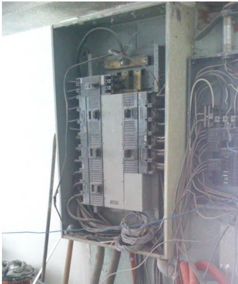
CAMBIO DE CABLEADO. EDIFICIO 104-D DE LA FACULTAD DE CIENCIAS DE LA COMPUTACIÓN. FUENTE: ARCHIVO PERSONAL ( Anexo No.118 )
