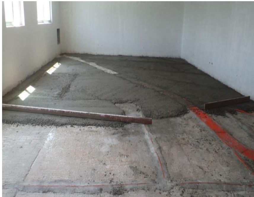
DUCTERÍA EN PISO. PRIMER NIVEL. EDIFICIO 104-D DE LA FACULTAD DE CIENCIAS DE LA COMPUTACIÓN. FUENTE: ARCHIVO PERSONAL ( Anexo No.115 )
