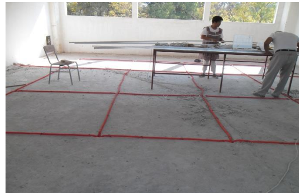
DUCTERÍA EN PISO. 2° NIVEL. EDIFICIO 104-D DE LA FACULTAD DE CIENCIAS DE LA COMPUTACIÓN. FUENTE: ARCHIVO PERSONAL ( Anexo No.114 )
