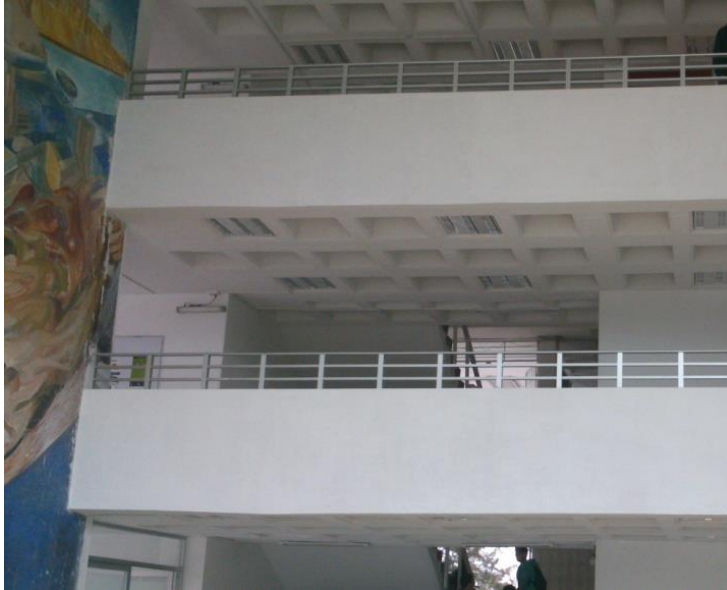
COLOCACIÓN DE BARANDAL VESTÍBULO PRINCIPAL. EDIFICIO 104-D DE LA FAC. DE CS. DE LA COMPUTACIÓN. FUENTE: ARCHIVO PERSONAL ( Anexo No.124 )
