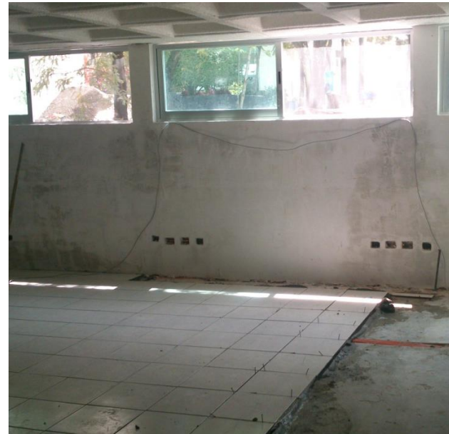
COLOCACIÓN DE CANCELERÍA NUEVA. EDIFICIO 104-D DE LA FACULTAD DE CIENCIAS DE LA COMPUTACIÓN. FUENTE: ARCHIVO PERSONAL ( Anexo No.117 )
