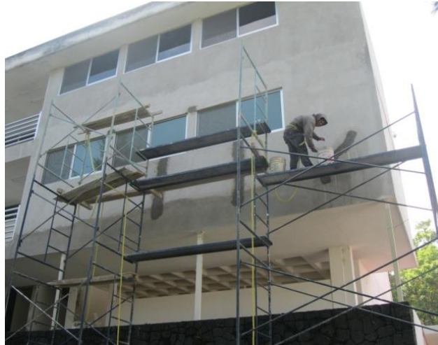
RESANE EN FACHADAS. EDIFICIO 104-D DE LA FACULTAD DE CIENCIAS DE LA COMPUTACIÓN. FUENTE: ARCHIVO PERSONAL ( Anexo No.120 )
