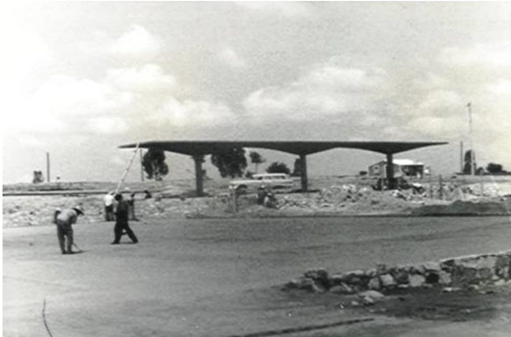
TERRACERÍA DEL ESTACIONAMIENTO DE ARQUITECTURA Y PARABOLOIDES DE LA PARADA DE AUTOBUSES.
