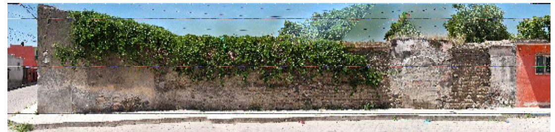
Registro fotográfico de deterioros por perfil o larguillo. Autor: Alejandro Sánchez
