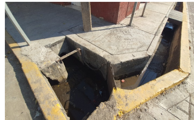
Compuerta metálica para desviar la dirección del agua, ubicada en el cruce de la avenida de la Juventud y la calle 4 sur. Fotografía: Arq. Alejandro Sánchez
