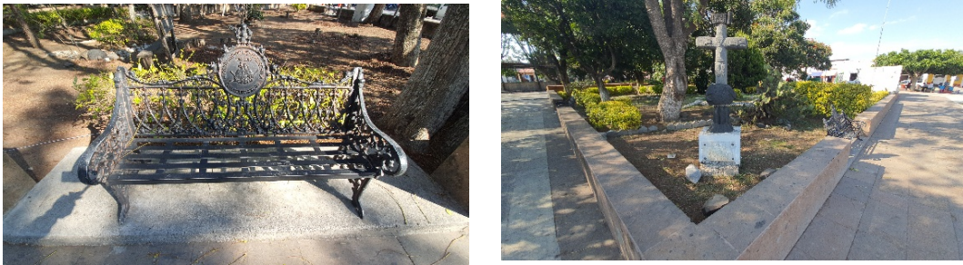
Vista del estado actual de las bancas de fierro colado ubicadas en la plaza central, así como de las jardineras monolíticas que sirven como asientos para los usuarios. Fotografía: Arq. Alejandro Sánchez
