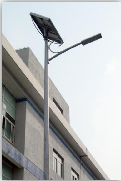
Imagen 65. Luminaria con panel solar
