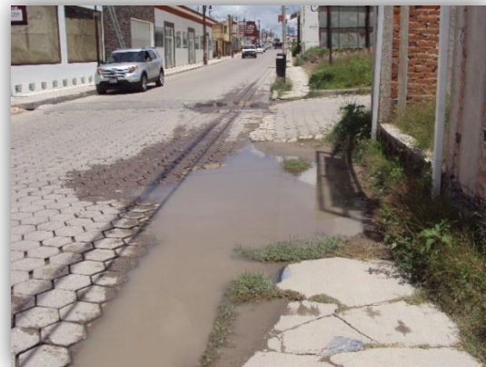
Imagen 13. Encharcamiento en banquetas
