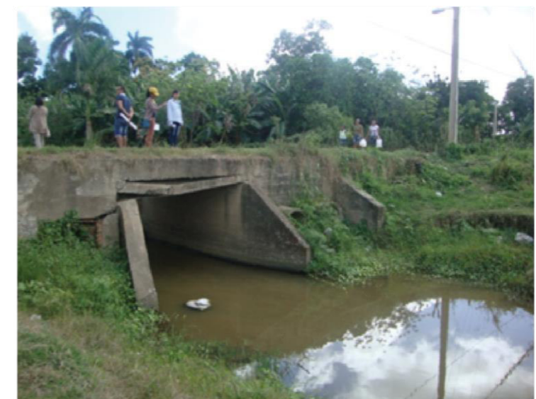
Este puente atraviesa el cauce del río Hatibonico, en la imagen se puede notar el deterioro del mismo. [Toma por Ángel Alberto Moreno Aguilar, el 19/02/2014]
