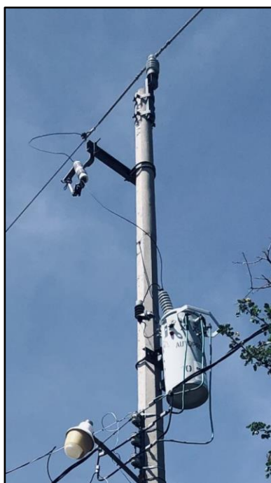
Figura 35. Protecciones de media tensión de transformador autoprotegido tipo poste de 10 kVA.
