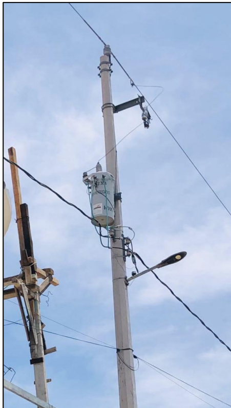
Figura 40. Protecciones de media tensión de transformador autoprotegido tipo poste de 10 kVA.
