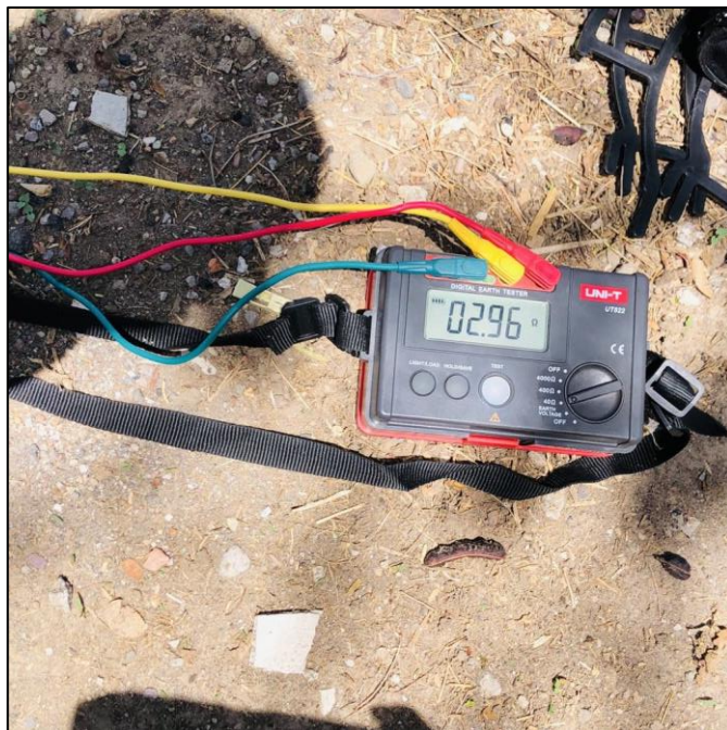
Figura 38. Resistencia de electrodo puesto a tierra de transformador autoprotegido de 10 kVA.
