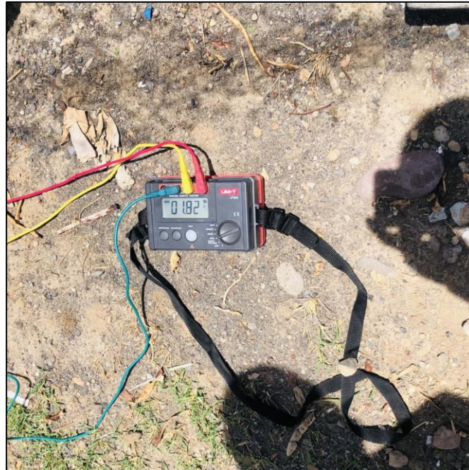
Figura 42. Resistencia de electrodo puesto a tierra de transformador autoprotegido de 10 kVA.
