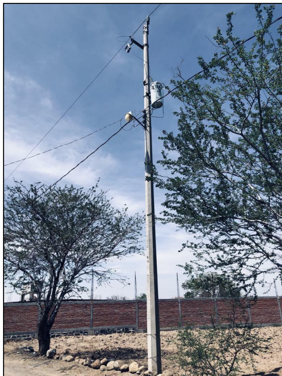
Figura 34. Transformador autoprotegido tipo poste de 10 kVA.
