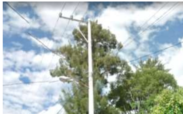
Figura 2.11.2.1 Poste eléctrico de concreto. Fuente: Google Maps
