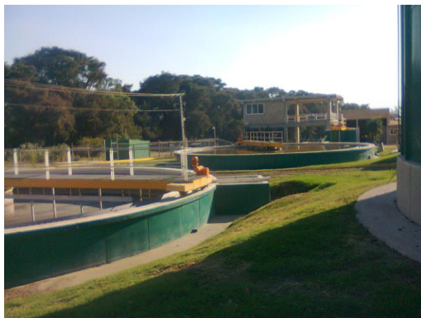
Figura 55. Tanques sedimentadores de la PTAR del municipio de Izúcar de Matamoros.
