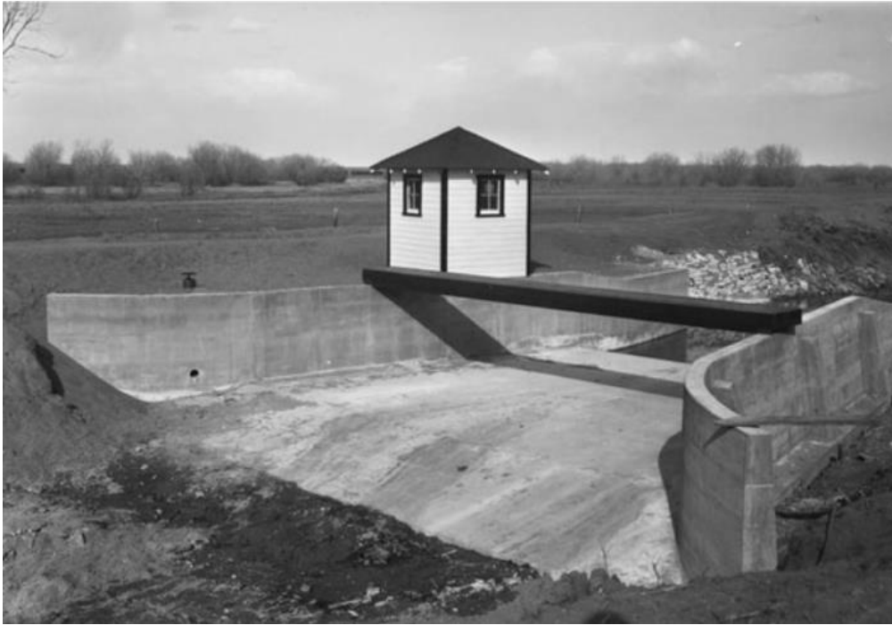
Figura 4. Canal Parshall instalado (Heyrani et al. 2022).
