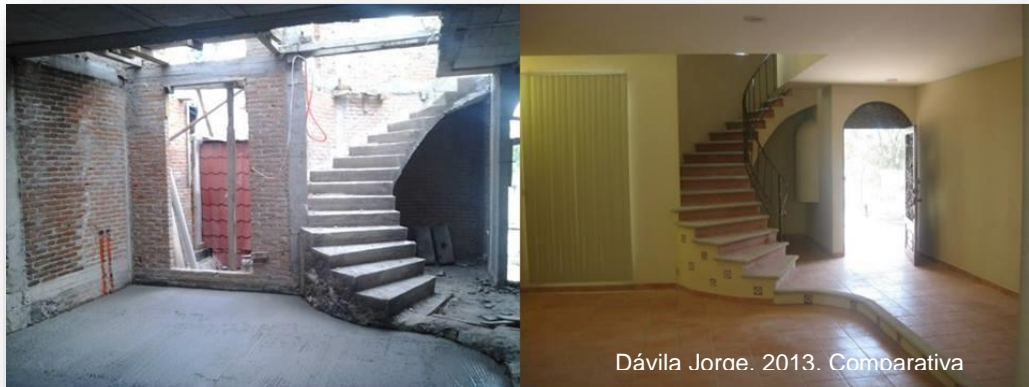
El Antes y el Después “Escaleras”
