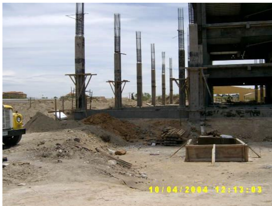
Foto 3. Concreto en columnas
