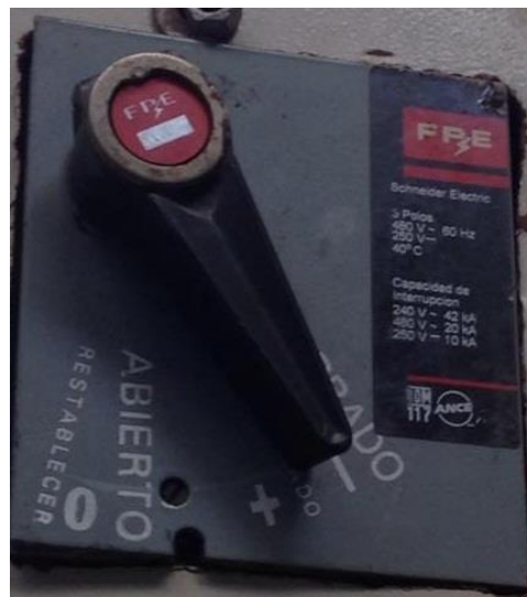
Imagen 11 Palanca de apagado-encendido. (CV)
