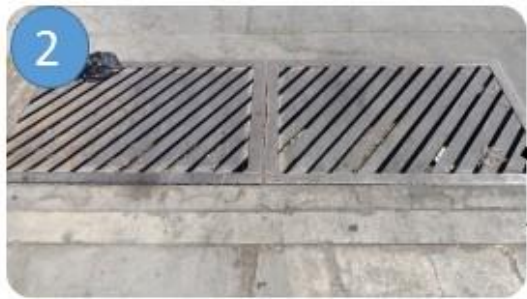
Ilustración 2. Candia, A. El lugar cuenta con dos alcantarillas para el control de escurrimiento pluvial.
