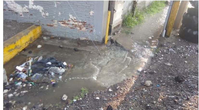
Ilustración (28). Rojas, S. (2019). Encharcamiento hacia una coladera el cual se encuentra tapada por basura que arrastra. [Foto]. Elaboración propia.
